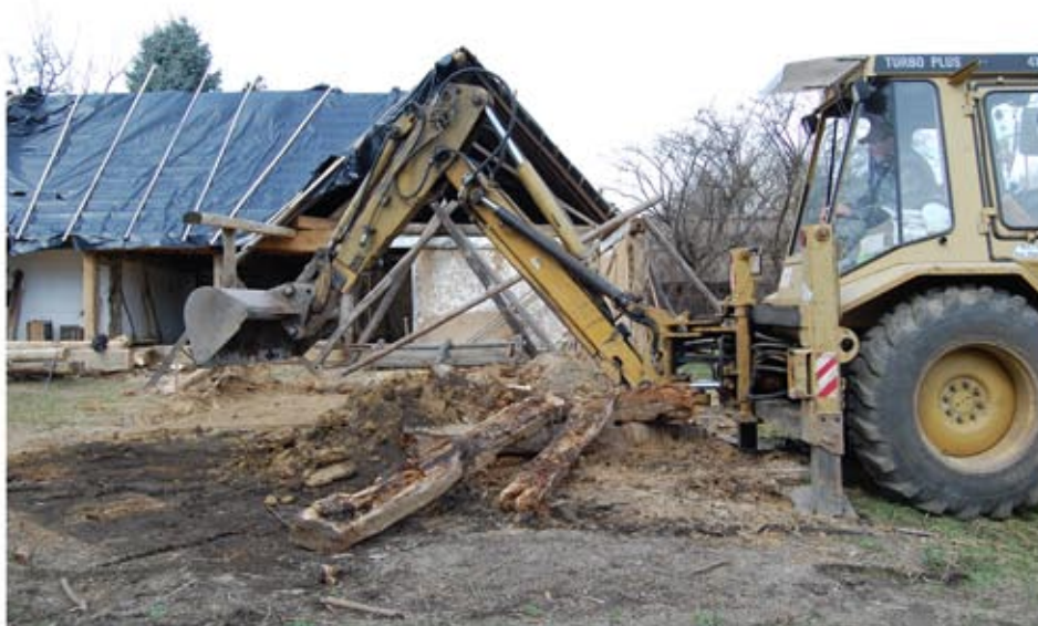
Az istálló talpgerendái és oszlopai teljesen elkorhadtak. Az épületrészt teljesen újjá kellett építeni.
